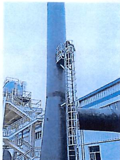
锅炉废气排气筒
