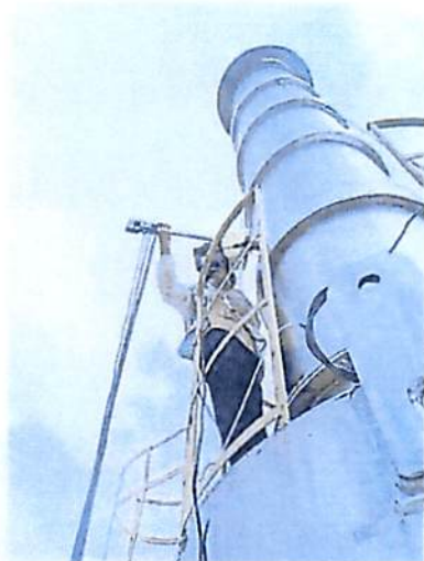
1号厂房有机废气排气筒
